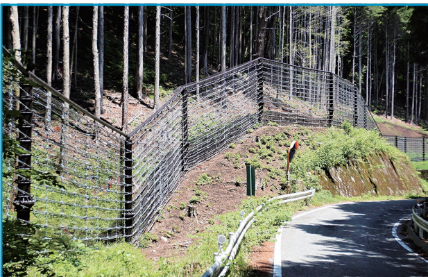
発注者 群馬県高崎土木事務所 工事件名 観光・社会資本総合整備(防災・安全)防災(3ヵ年緊急対策)(分第3号)高エネルギー・現収型落石防護網設置 主要地方道 高崎東環状線 高崎市箕郷町松之沢地内 施工箇所 群馬県高崎市箕郷町松之沢地内 施工延長 65m 落石エネルギー 883kJ
