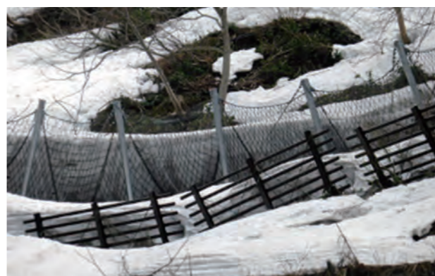
発注者：国土交通省東北地方整備局月山ダム管理所 工事件名：月山ダム法面対策工事 施工箇所：山形県鶴岡市上名川地内 施工延長：58.5m
