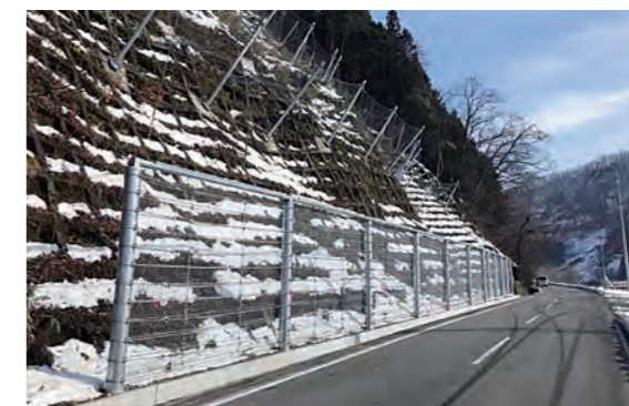
発注者：山形県最上総合支庁 工事件名：平成30年度(明許線越) 雪に強いみちづくり事業(交付金・補正) 主要地方道戸沢大蔵線雪崩予防施設設置工事 施工箇所：山形県最上郡戸沢村大字古口 施工延長：56m
