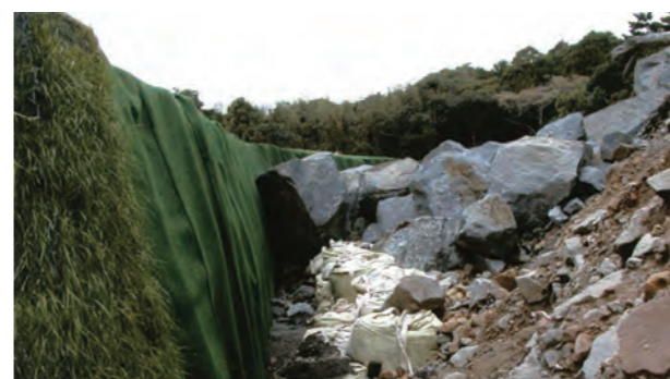
落石を受けた後の落石防護補強土壁
