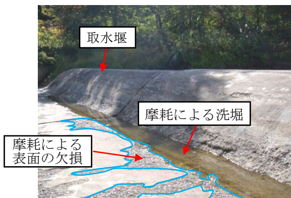
取水堰下流側に生じた摩耗
