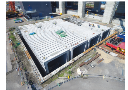
大規模貯水槽（多槽並列）
