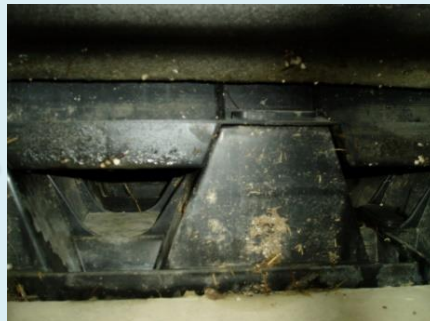
プラスチック槽 内部に堆砂
