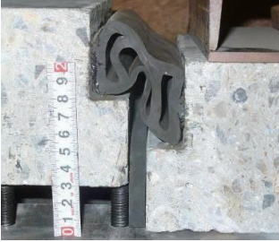
段差変形の状態
