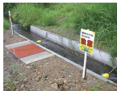
保安設備（危険注意看板と水難防止用フロート）
